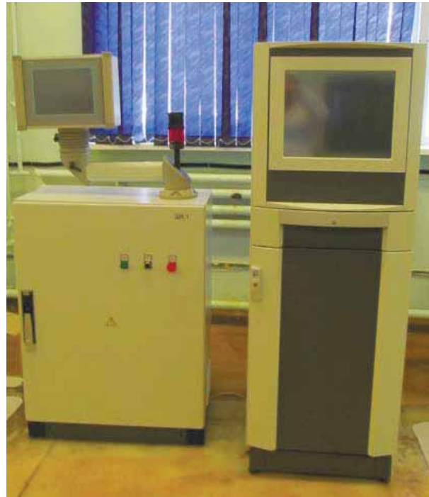
Внешний вид щита управления установкой контроля герметичности
